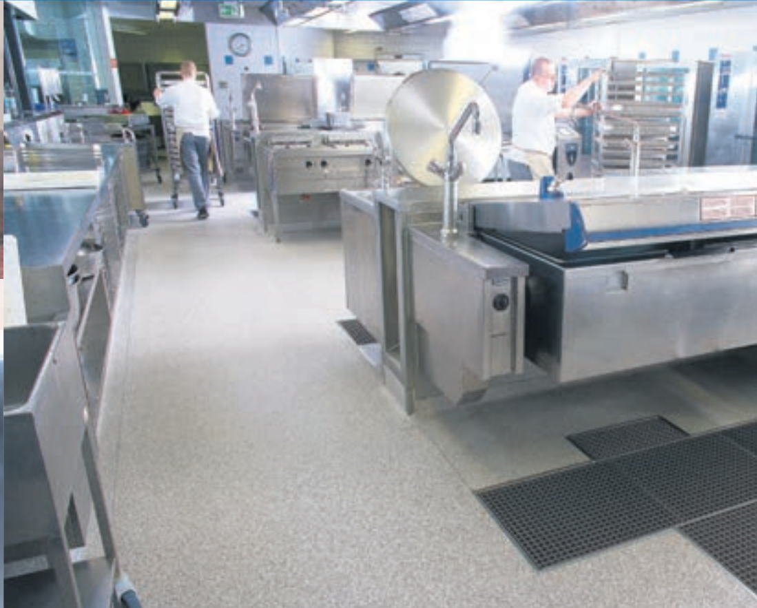
Nach der neuen DIN-Norm wird die Abdichtungsebene des Bodens soweit wie möglich nach oben verlagert. Ein eingearbeitetes Gefälle ist nach der neuen Norm in Großküchen nicht mehr nötig.
